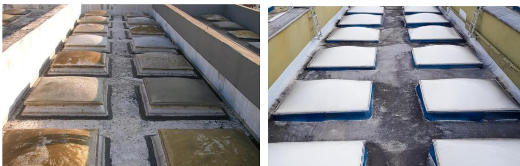
Figura 3 – À esquerda, vista externa da cobertura original, mostrando o estado de degradação da fibra de vidro. À direita, vista externa da cobertura com as novas claraboias em acrílico leitoso. Fonte: Imagem à esquerda: Claudia Oliveira, disponível em: < http://docomomo.org.br/wp-content/uploads/2016/01/069.pdf >, acesso em fevereiro de 2020; imagem à direita: Os autores.
